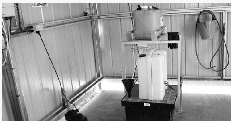
MT LIEBIG CHLORINATION UNIT.
